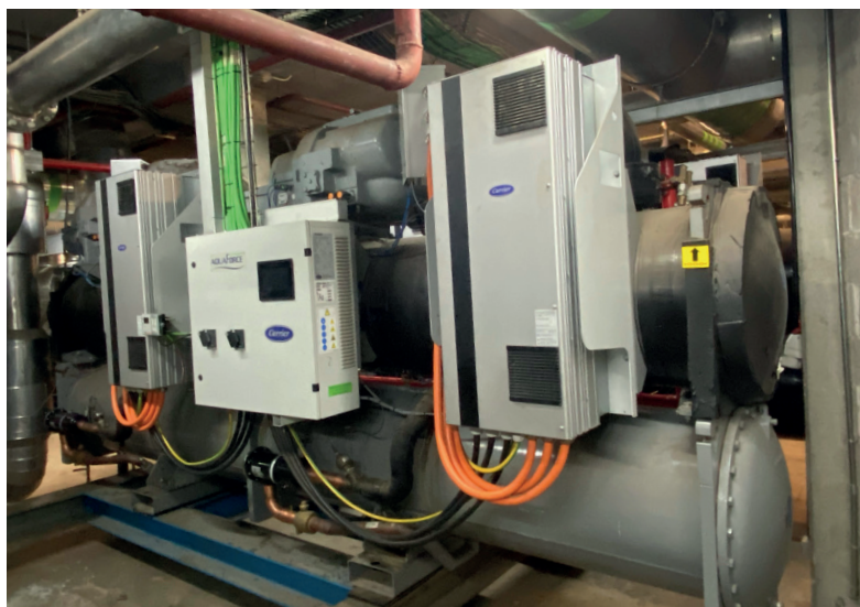
Equipos de refrigeración
