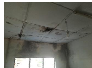
Photo 10 : Plafond endommagé d'un USP
